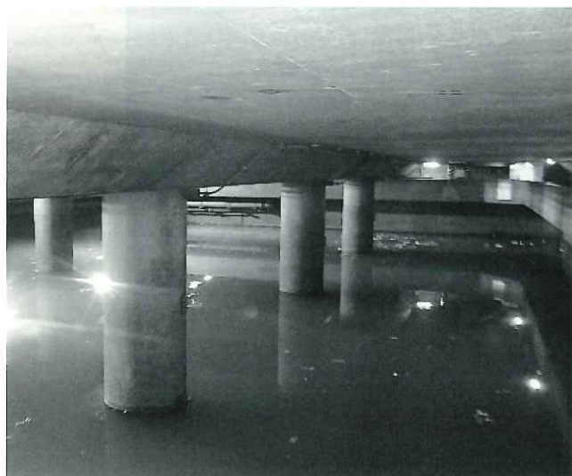
写真1：札幌駅北口融雪槽内部
