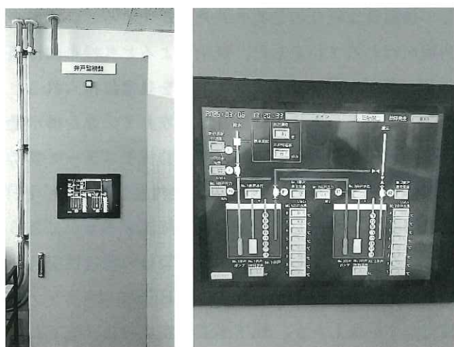
写真3、4：新栄クリエイト株式会社内の井戸監視盤とモニター
