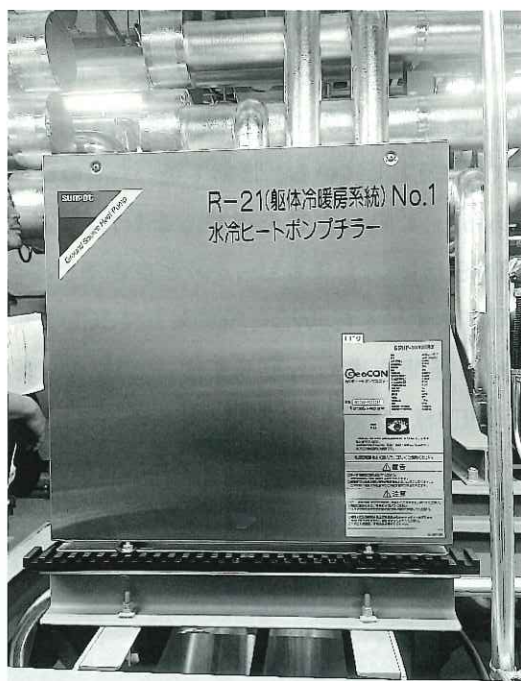
写真6：古平町複合施設内のヒートポンプ
