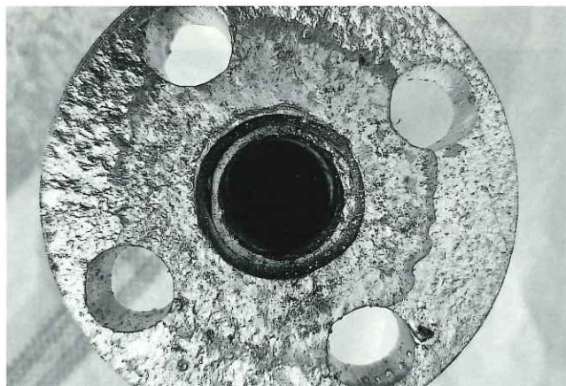
不良加工管（溶接不良と、濡れただけで溶けた配管表面の塗装）
