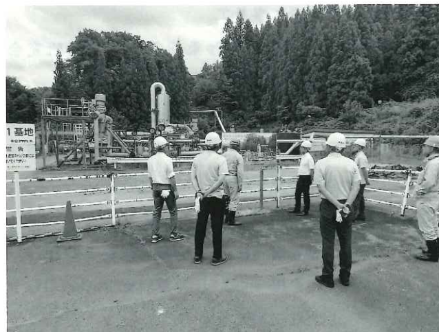
蒸気生産設備P1基地
