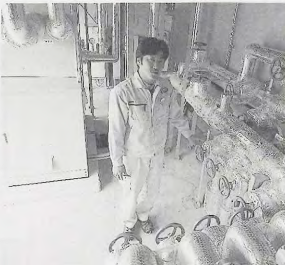
地下水をくみ上げる井戸について説明する黒沼さん。左奥の箱がヒートポンプ=いずれも山形市高木
