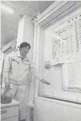
地下水からの熱を使って温風が出るユニット（下）。古いエアコン（上）は使っていない
