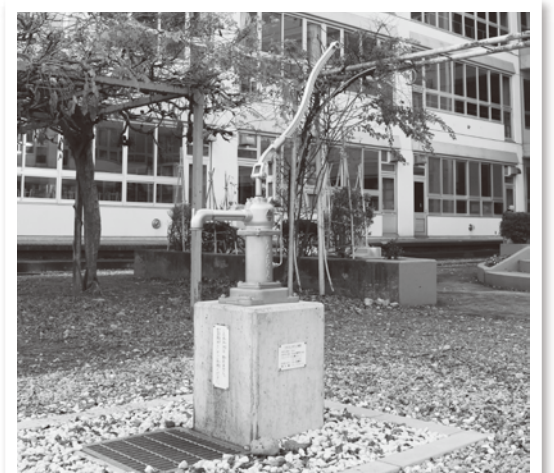
※2016年に山形県さく井技術協会が寄贈し、 山形二中に設置された手押しの防災井戸。
