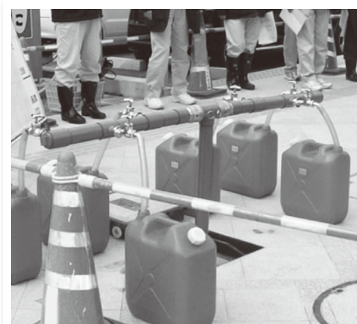
※2007年に山形市相生町の歩道に設置された、 消雪用井戸を活用した防災井戸キット。
