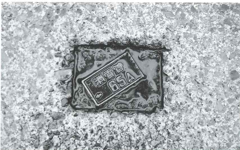
本管の径を示す銘板 (市内で見つけた散水消雪施設より)
