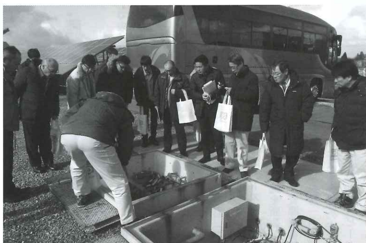
井戸熱源設備の見学
