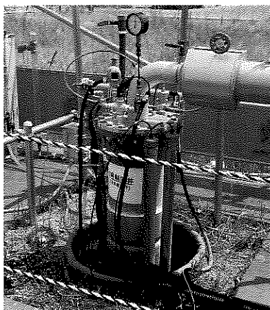
うめきた再開発地区帯水層蓄熱システム 揚水・還元兼用井戸地上部
