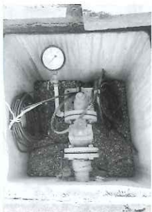
三建設備工業 井戸ピット内
