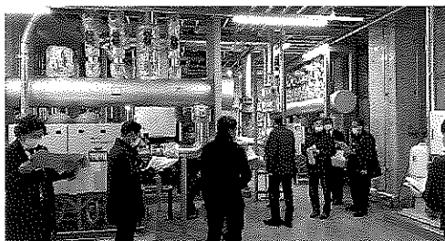
SAGAアクア内 各種再生可能エネルギー熱源施設
