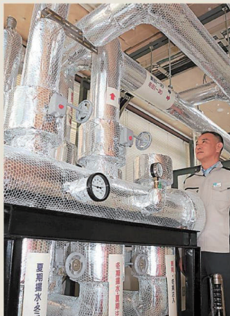
日本地下水開発が構築した帯水層蓄熱冷暖房システム（山形市・同社）
